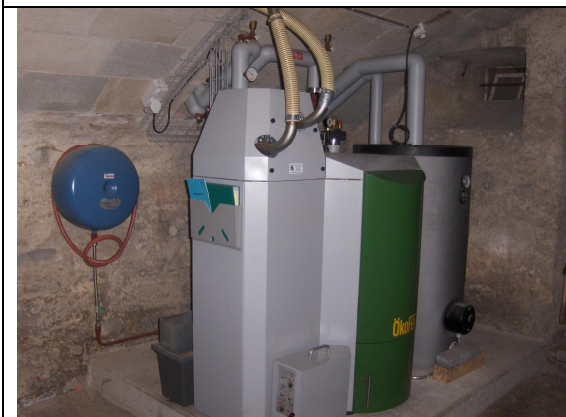
Pelletheizung und Boiler
