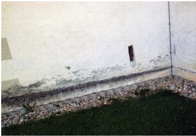
Feuchtigkeit, Fasadenschäden, defekte Sickerleitungen
