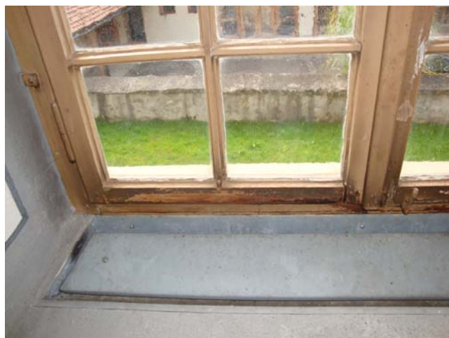
Schadhafte und undichte Holzfenster
