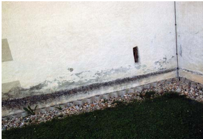
Feuchtigkeit, Fassadenschäden, defekte Sickerleitungen
