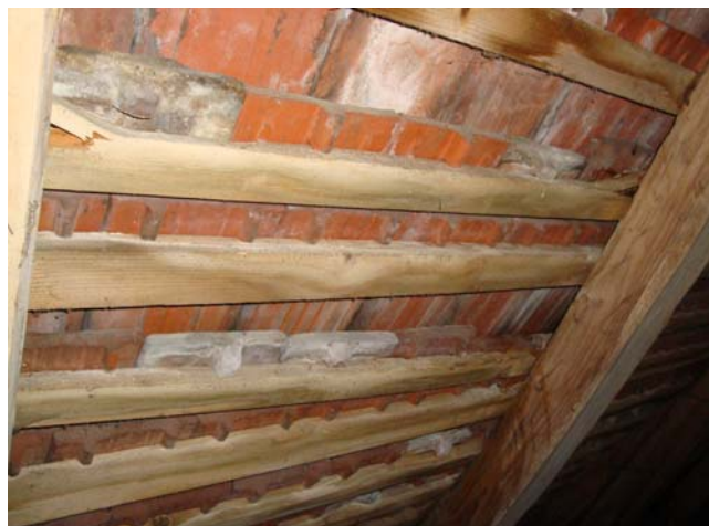
Morsche Dachlatten, lose Ziegel (Dach Nordseite)
